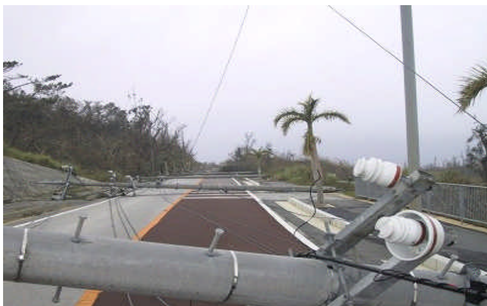
【台風14号により倒壊した電柱】
